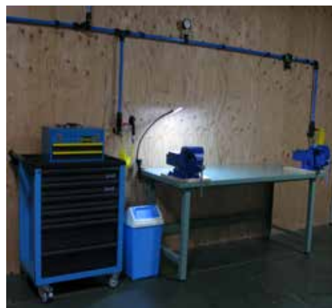
エアツール等修理スペース 大型コンプレッサー、各種フィルターにより クリーンなエアが供給されています。
